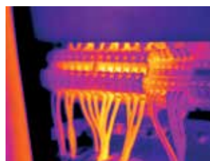
Détecter les composants électriques défectueux.
